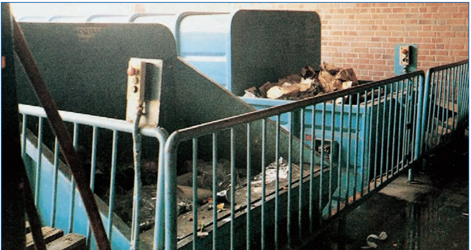
Bild 4: Zwei Pressbehälter für Papierabfälle und Müll mit Sicherung gegen Hineinstürzen von Personen durch ein 1 m hohes Geländer mit Gitterstäben. Durch den genügenden Abstand des Geländers zu der Kante der Rampe wird ein Abgleiten der Füße verhindert und durch die gegebene Fußfreiheit die Standsicherheit der Bedienungsperson erhöht.
